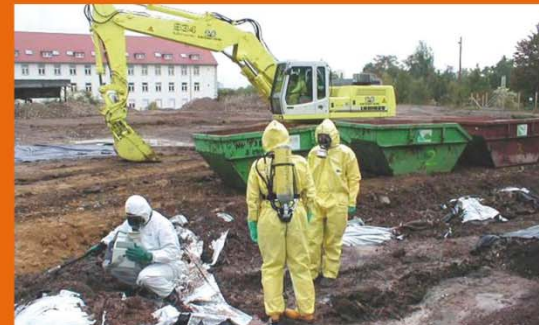
Der Informationsbedarf: Altlasten-Risiko?
