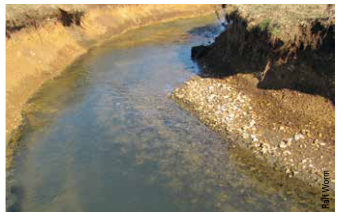
Abbildung 7: Bereits nach einem Hochwasser hat sich – neun Monate nach dem Bau – ein sehr naturnahes Querprofil mit Prall- und Gleithang ausgebildet.
