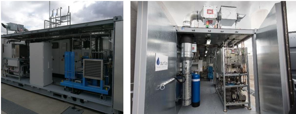
Abbildung 2: SOEC-System Container installiert an der H 2 -Tankstelle von Total in Karlsruhe
