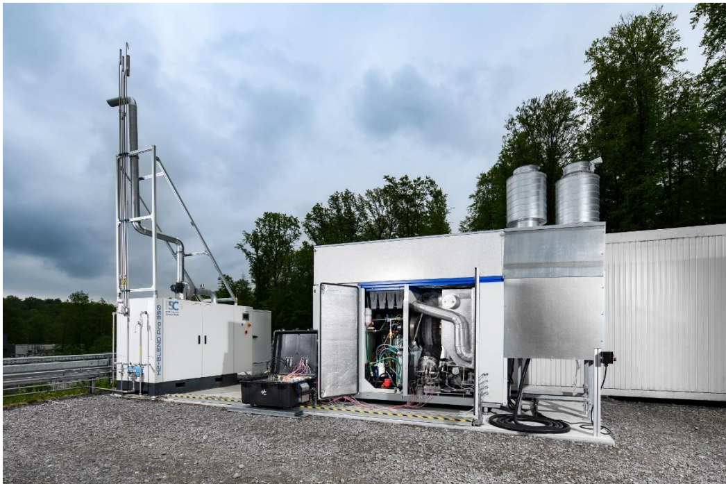
Abbildung 4-7 Gesamtübersicht der Anlage
