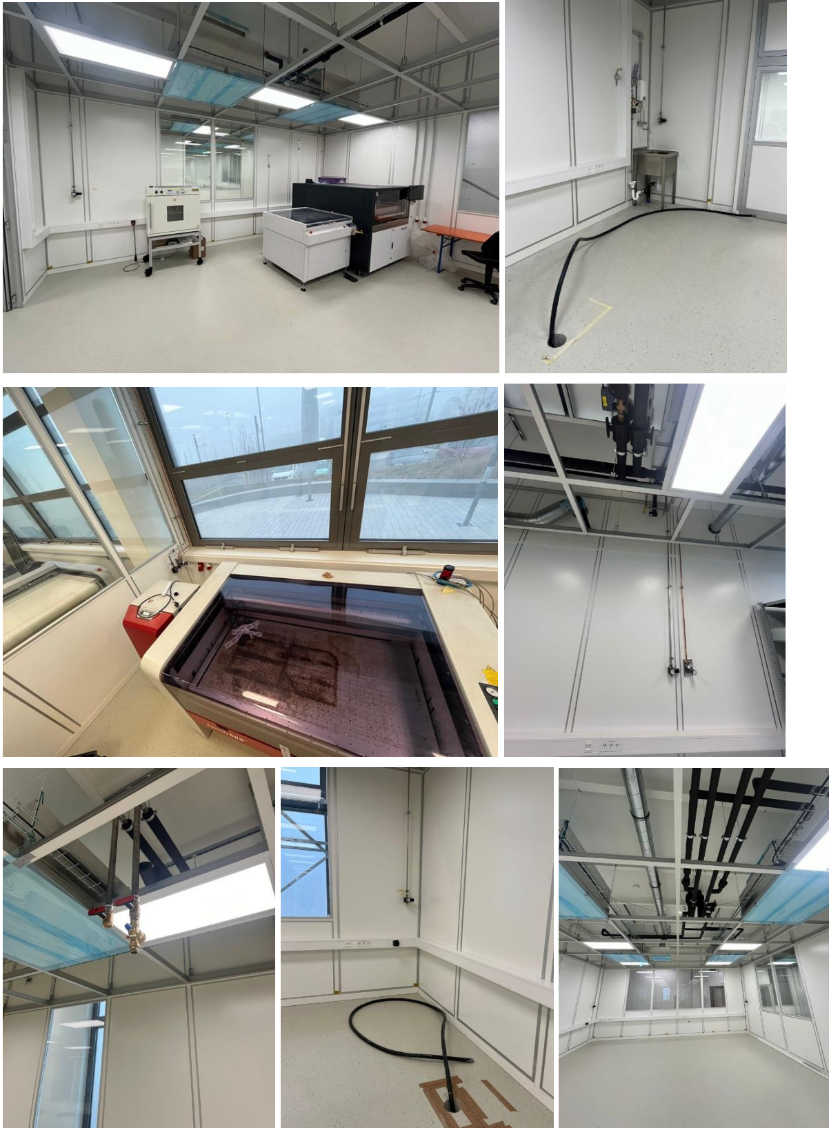
Abbildung 7: Elektrische und medienseitige Anschlüsse wie Druckluft, Kühlwasser, Stickstoffversorgung sowie Zu- und Abluft in HyFaB2
