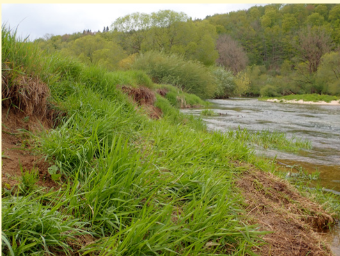
Die ehemalige Ufersicherung der Donau wurde aberodiert.
