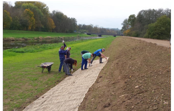
Einbau von Jutegewebe am wasserseitigen Dammfuß nach der Dammsanierung an der Elz 2015
