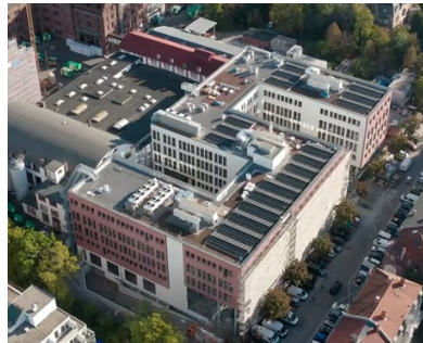
Abbildung 49: Die im Kontext von Smart East neu gebaute PV-Anlage auf dem iWerkx (99 kWp)
