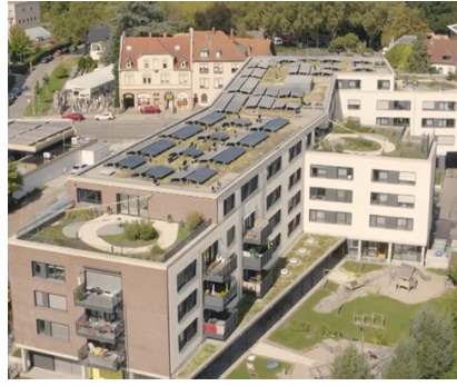
Abbildung 48: Die im Kontext von Smart East neu gebaute PV-Anlage auf dem Mehrgenerationenhaus (99 kWp)
