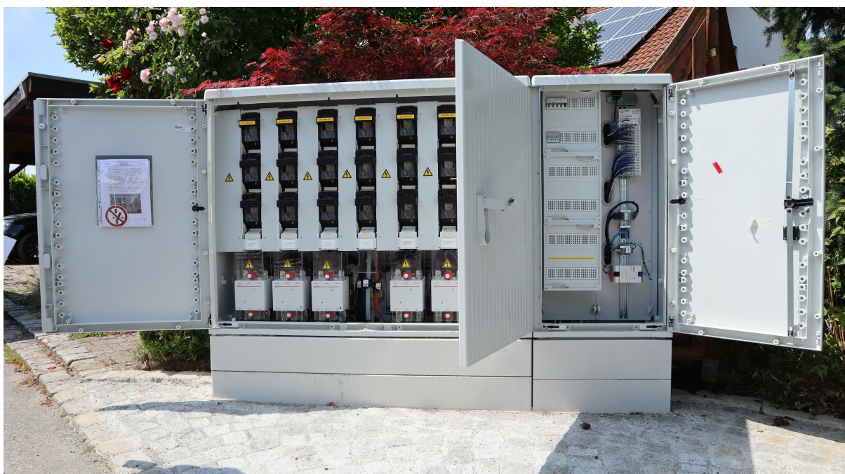
Abbildung 5: Schaltbarer Kabelverteiler im Netz
