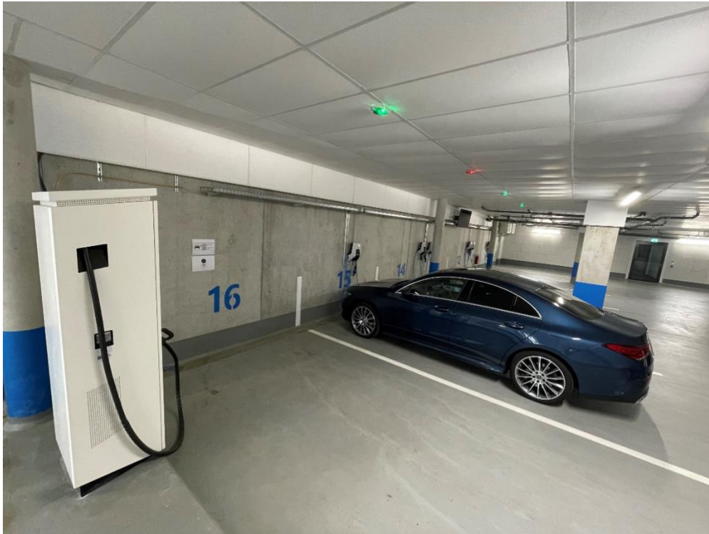
Abbildung 22: Ladeinfrastruktur der OWP12 inkl. Schnelllader, Foto: Fabian Gierl
