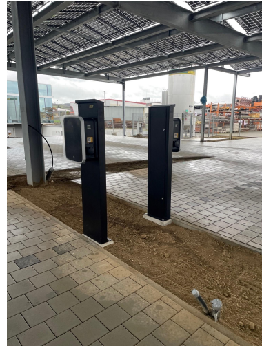
Abbildung 4: Ladepunkte unter dem PV-Carport (Quelle: Ralf Bickel)
