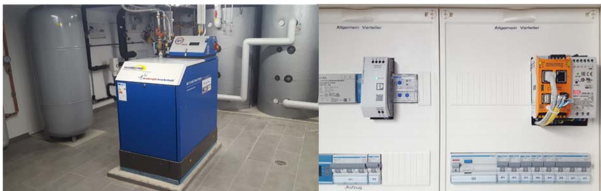
Abbildung 57: Das installierte BHKW mit Pufferspeichern und der dies steuernde Revolution Pi mit EMS im Schaltschrank
