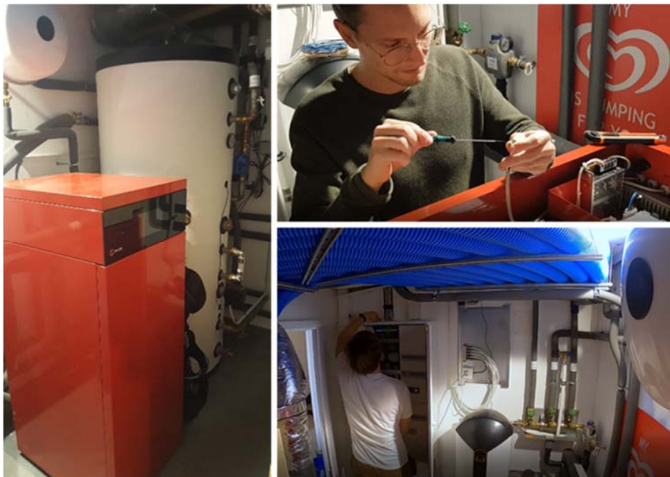
Abbildung 61: Eine beispielhaft installierte Weider Wärmepumpe mit Pufferspeicher und die Installation der seriellen Schnittstelle zum EMS im Schaltschrank
