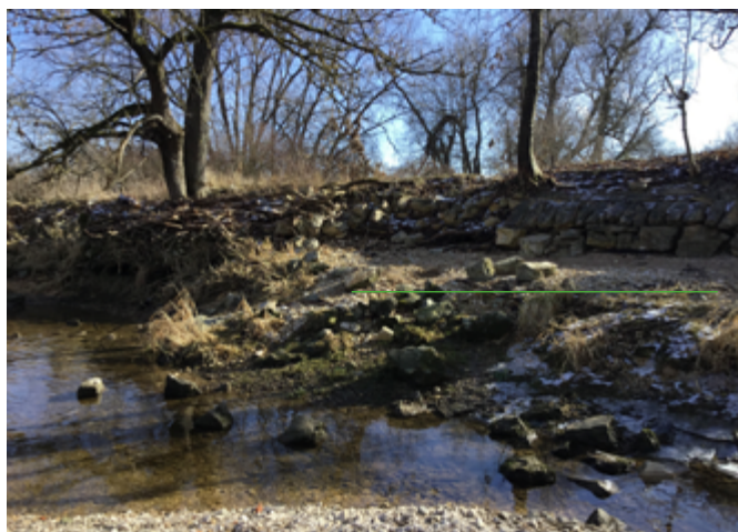
Tiefenerosion (grüner Strich zeigt die ehemalige Ufersicherung, d. h. die alte Gewässersohle) [LRA Sigmaringen]
