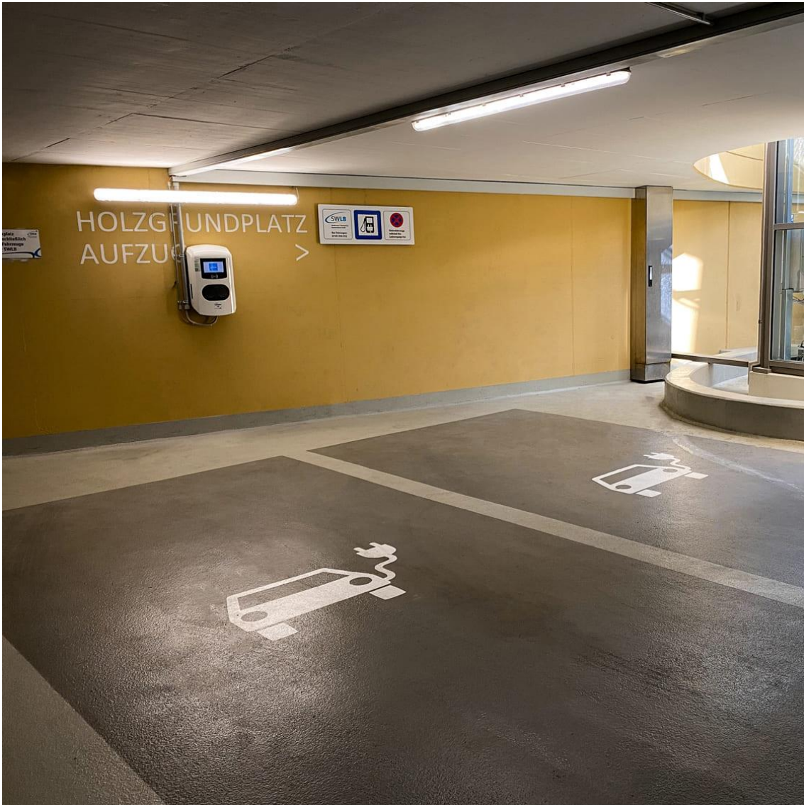
Abbildung 20: Ladeinfrastruktur Standort Holzgrund
