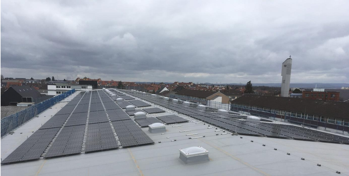
Abbildung 10: PV-Anlage auf Halle 8
