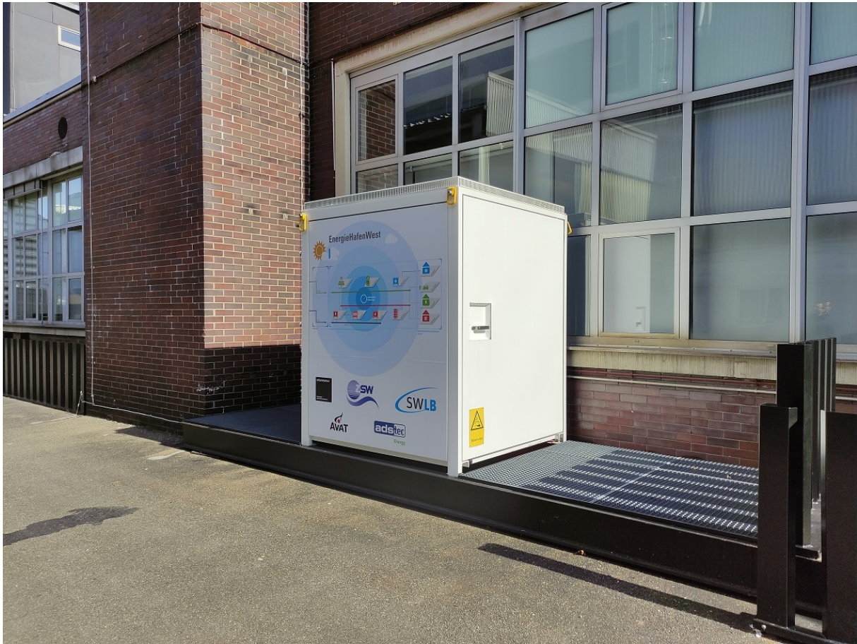
Abbildung 7: Batteriespeicher auf Unterkonstruktion
