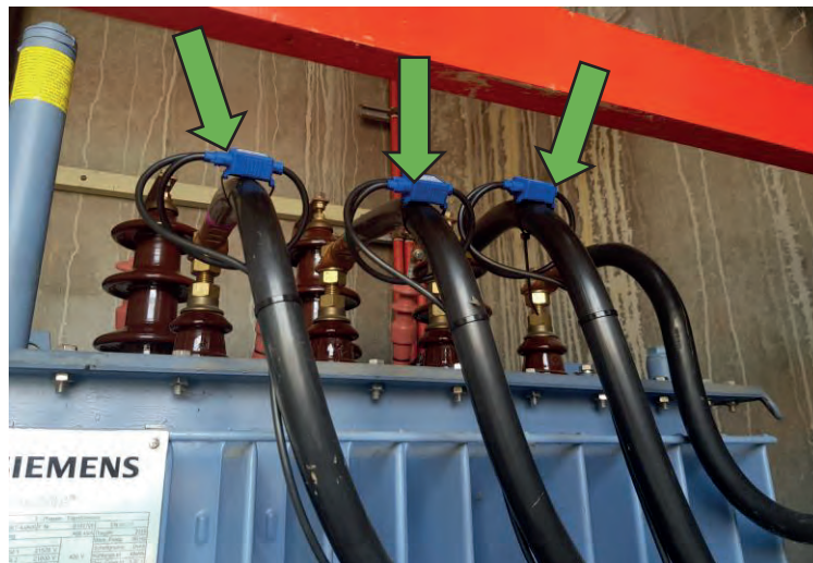
Abbildung 9: Installierte Rogowski-Spulen (siehe grüne Pfeile) zur Strommessung am Transformator in der Umspannstation Brühlstraße in Sachsenhausen
