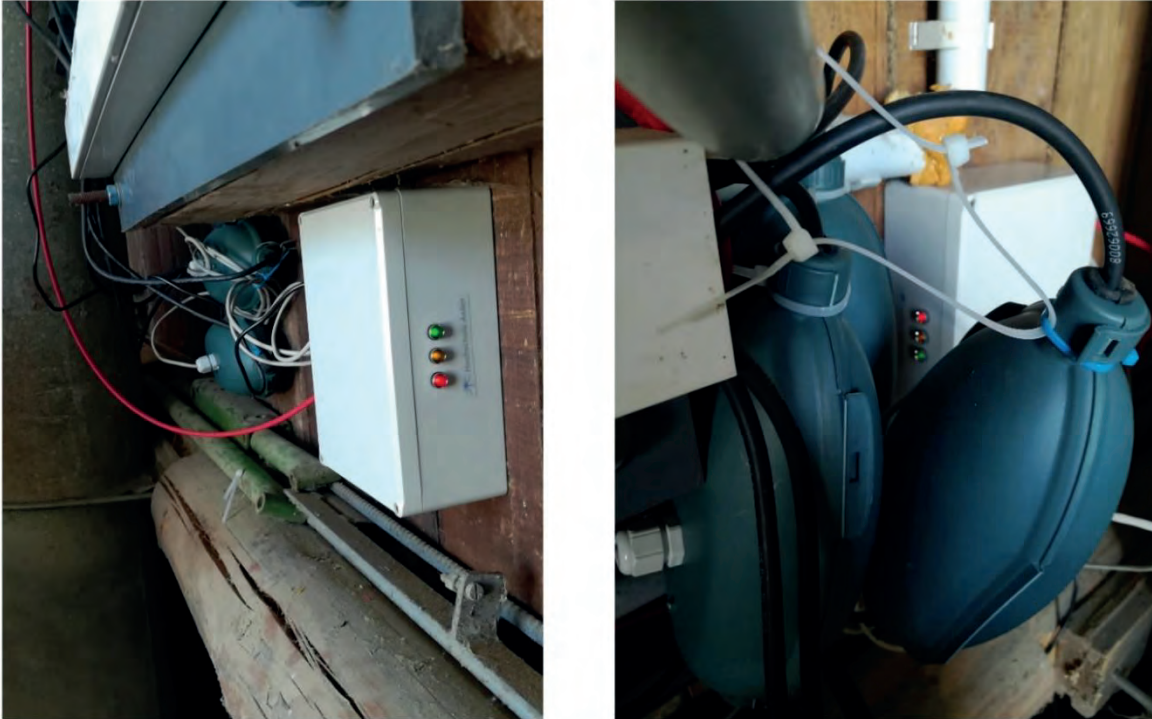
Abbildung 3: Darstellung des bei einem Pilotkunden installierten Online Monitoring Systems
