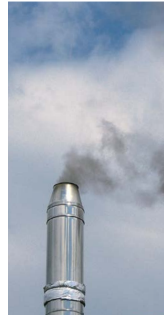
Rauchgase müssen frei abziehen können.
