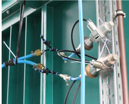
Abbildung 53: Aufbau der Reingasmessungen an der NMA
