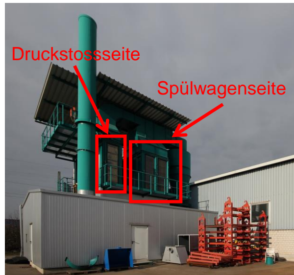
Abbildung 39: Außenansicht der Nederman-Anlage
