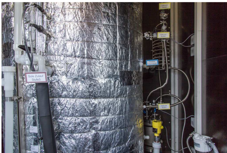
Abbildung 4.20 - Desorptionsanlage im 40' Container
