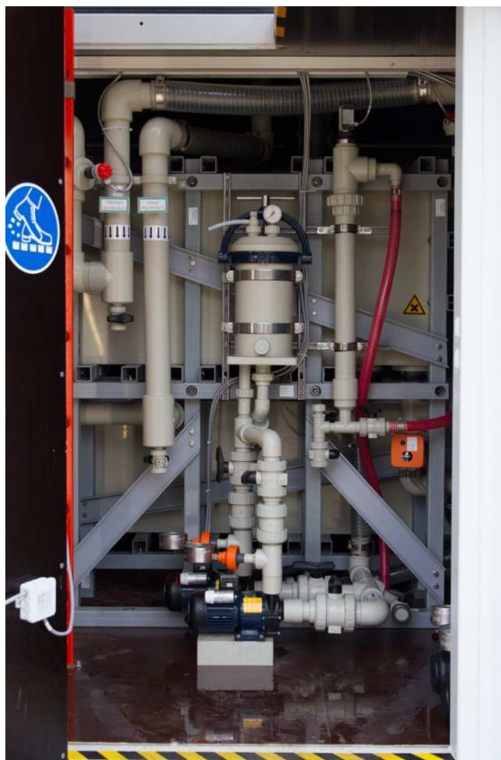
Abbildung 4.19 – Vor- und Rücklaufbehälter der Absorption mit Filter und Pumpen
