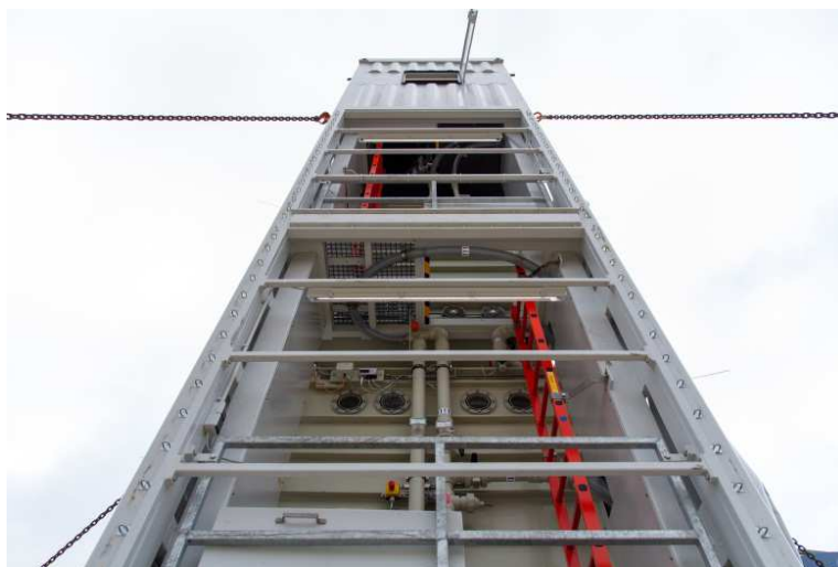
Abbildung 4.15 - 40' Container, Seitenansicht Absorptionsmodule
