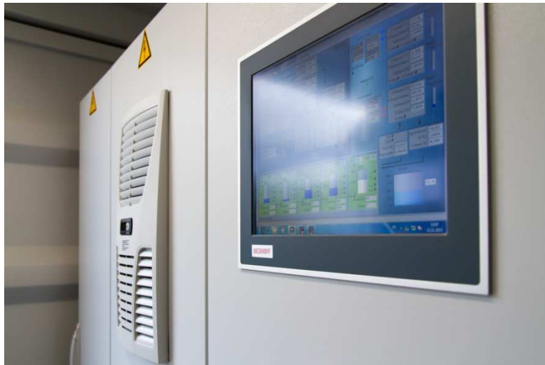
Abbildung 4.17 - Schaltschrank im Technikcontainer
