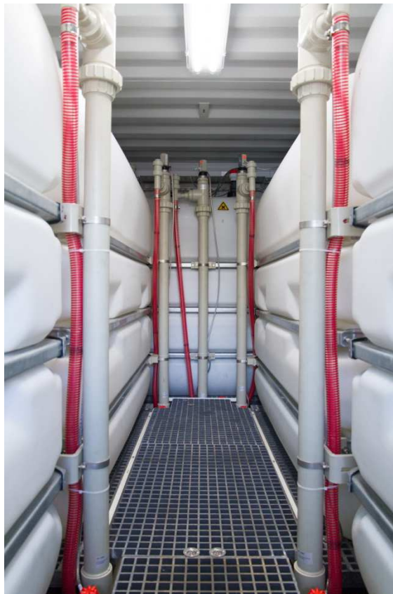
Abbildung 4.23 - Tanks im Solecontainer
