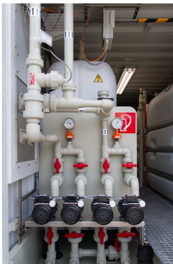
Abbildung 4.21 - Beschickungspumpen im Solecontainer
