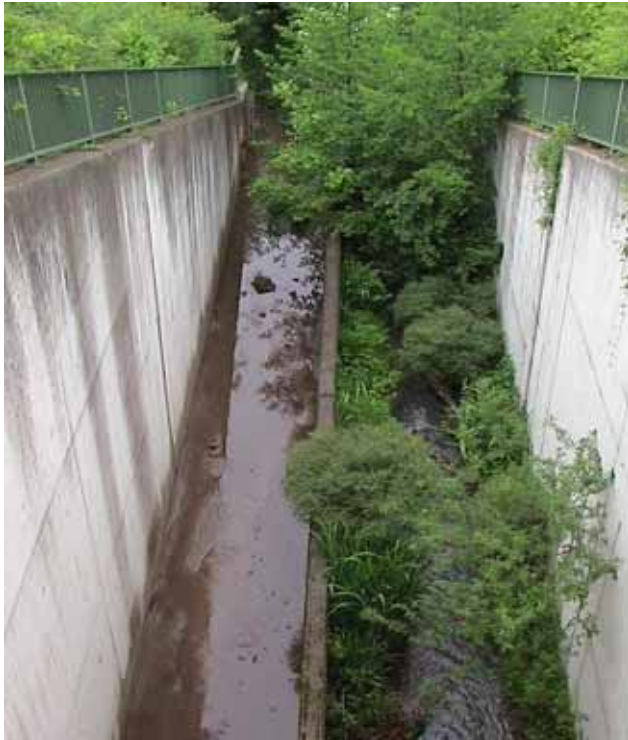
Abb. 5.20: Auslaufbereich des HRB Ellbach an der Sulm (rechts Ökogerinne mit Vegetation).
