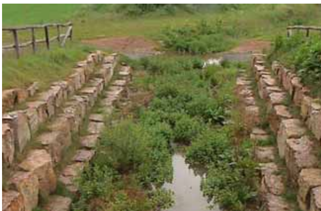
Abb. 3.4: Sedimentation durch unnatürliches Gefälle und Aufweitung des Gewässerbetts, Bewuchs stellt sich ein.
