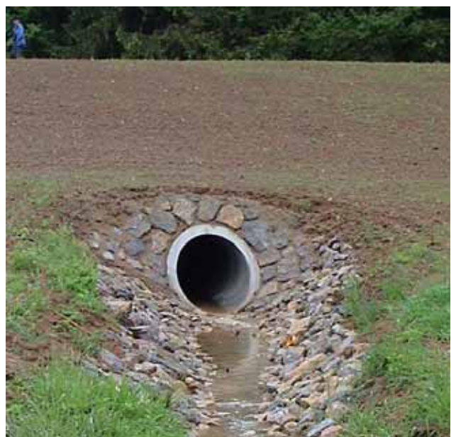
Abb. 3.8: Unterdimensionierter Rohrdurchlass eines HRB.
