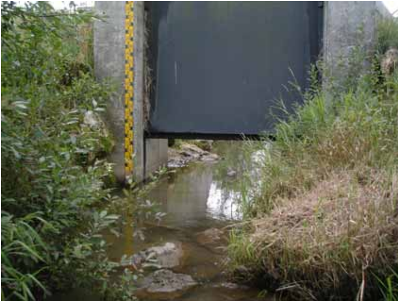
Abb. 7.8.3: Schieber des Betriebsauslass.
