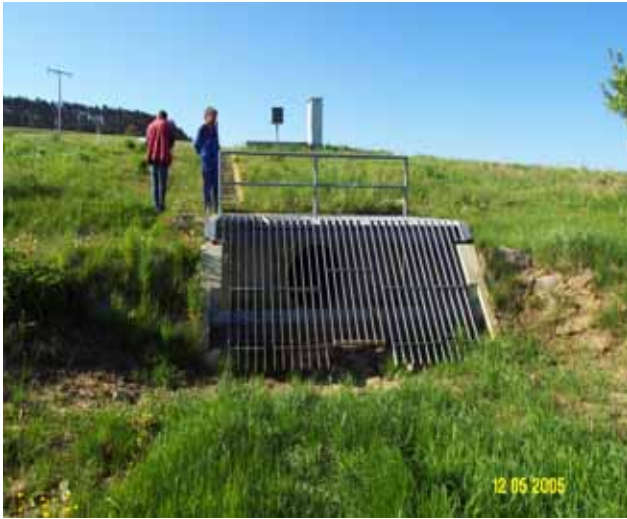
Abb. 5.28: Räumlicher Grobrechen mit Schlupf (Rechenmitte unten) beim HRB Aufragen.
