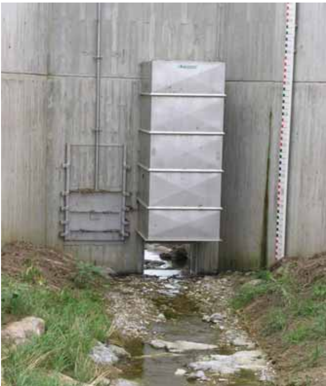
Abb. 5.23: HRB Apfelbach, ein schwimmergesteuerter Schieber (unter der Abdeckung).
