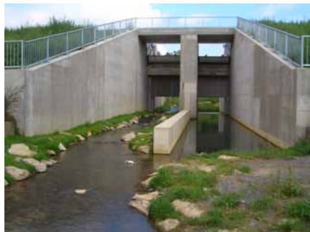
Abb. 5.19 : Unterstromansicht links der Gewässerkorridor, rechts der Betriebsauslass beim HRB Oberes Wiesental, Schefflenz.
