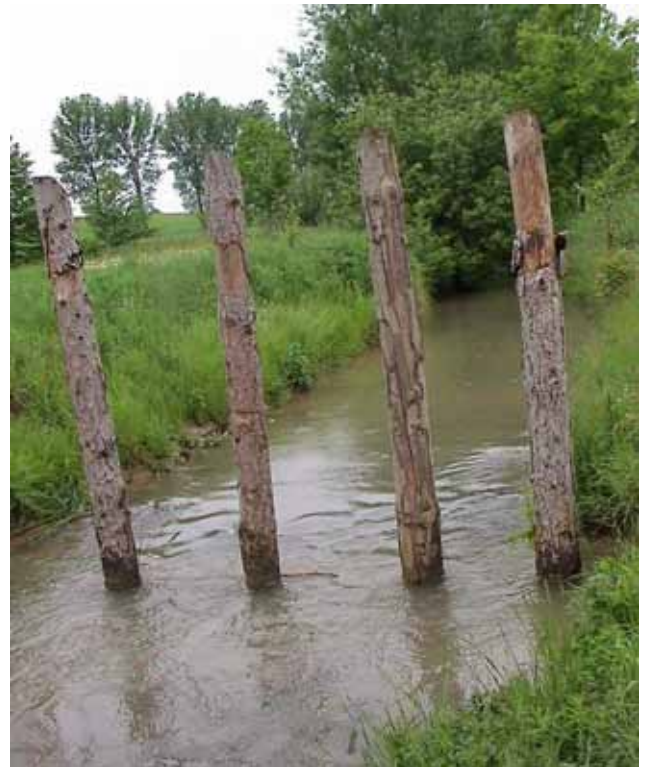
Abb. 5.26: Grober Vorrechen beim HRB Raußmühle, Elsenz.
