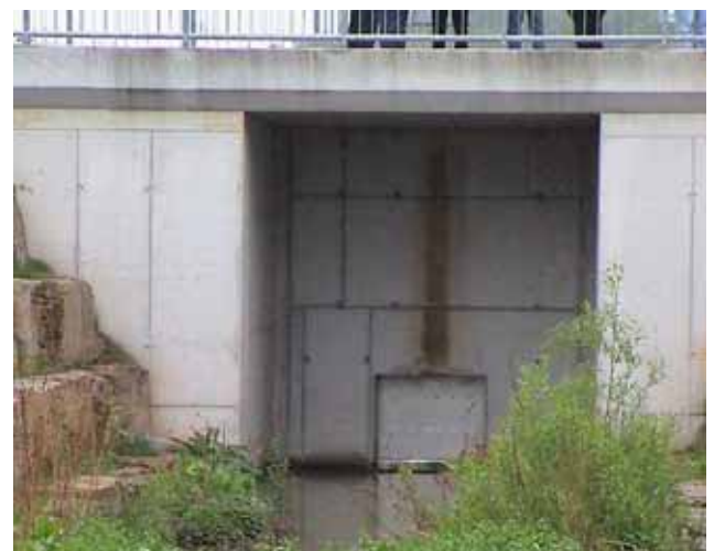
Abb. 3.9: Tiefe Schieberstellung ohne amphibischen Bereich unterbindet die Durchgängigkeit.
