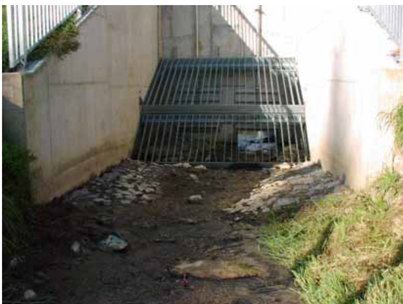
Abb. 7.2.4: Durchlassbauwerk mit 2 Schiebern.
