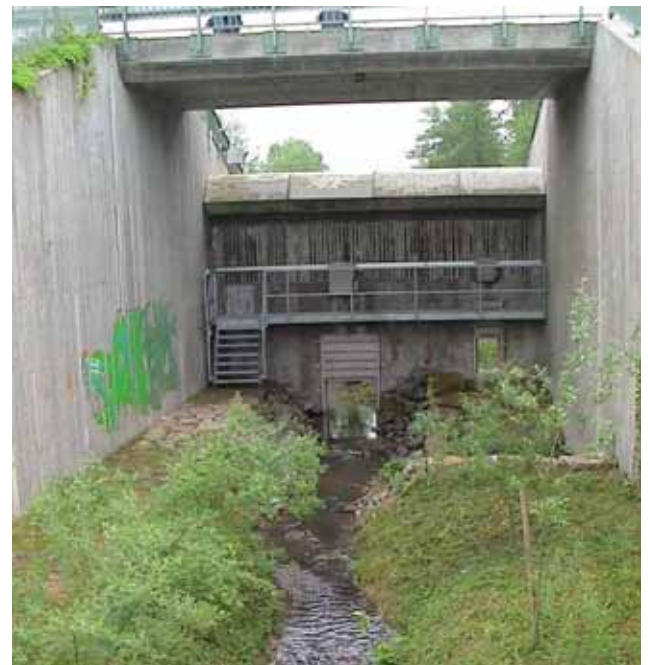
Abb. 5.15: Zwei Schieber und integrierte Hochwasserentlastung HRB Stadtseebach, Stadtseebach.
