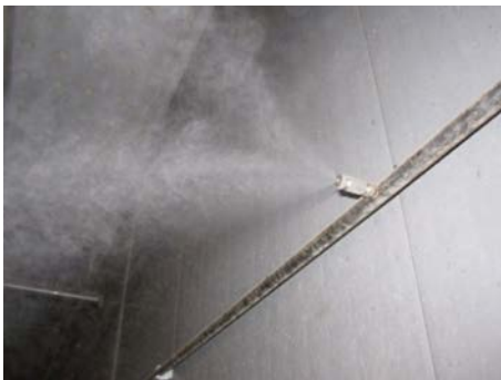
Abb. 5-11: Hochdruckdüse (70 bar) mit Wasservernebelung
