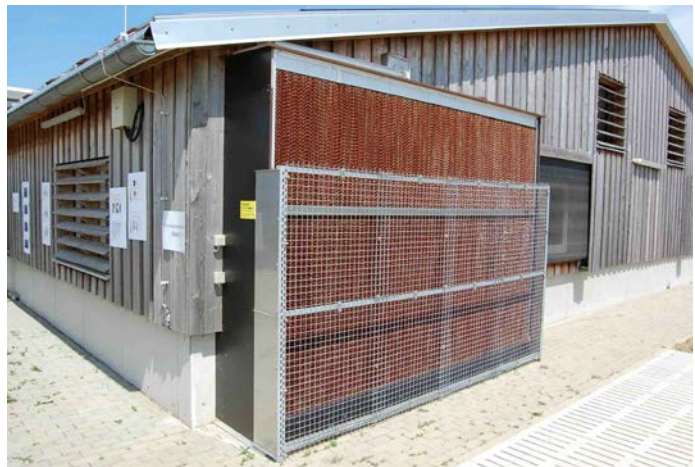
Abb. 5-12: Kühlpad an zentralem Lufteintritt
