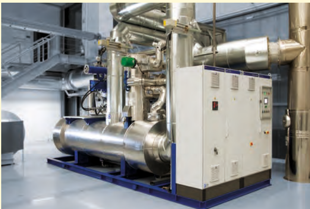
ABB. 12: ORC-ANLAGE IN BIETIGHEIM-BISSINGEN (DÜRR CYPLAN LTD. 2015)
