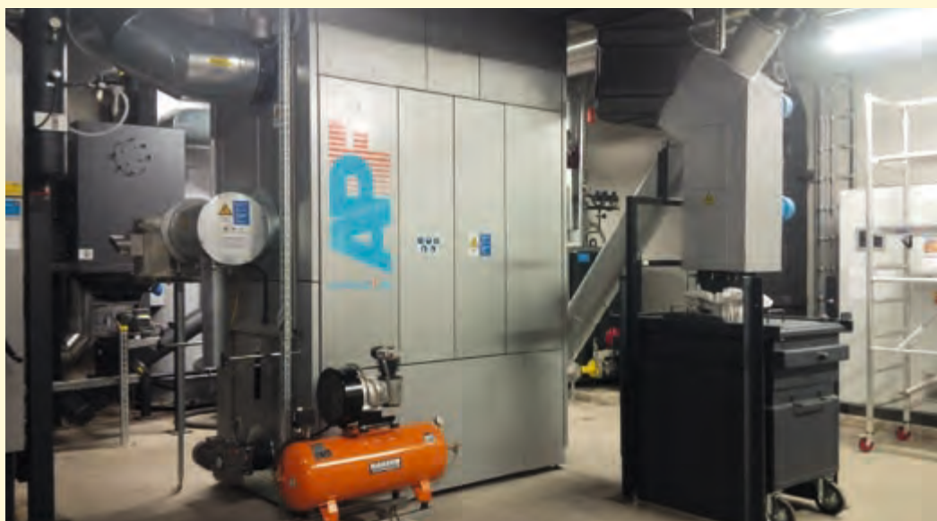
ABB. 27: AUFBEREITUNG VON GRÜNGUT; HEIZANLAGE IM LANDRATSAMT SIGMARINGEN
