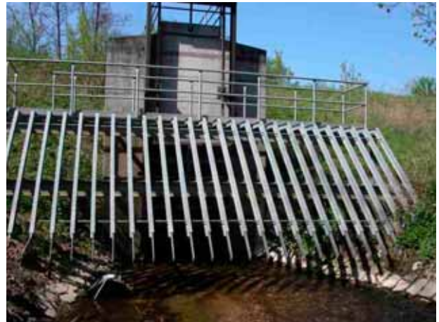
Abb. 6.7: Räumlicher Rechen am HRB Dietenbach
