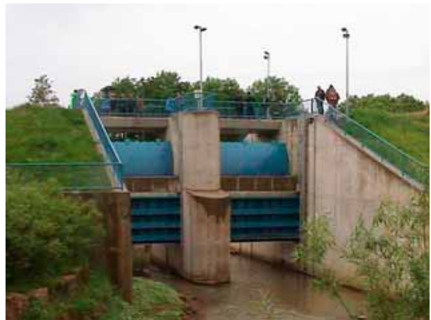
Abb. 6.2: Luftseitige Ansicht des offenen Durchlassbauwerks mit zwei Fischbauchklappen als HWEA, HRB Bernau.
