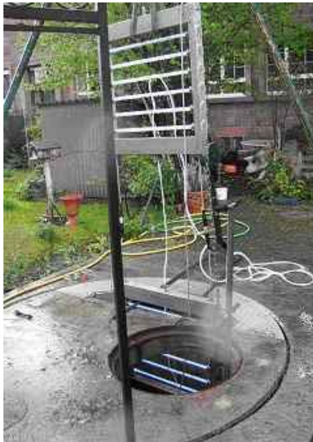
Abbildung 3-9 Einbau der UV-Strahlerrahmen in das Pilotgate
