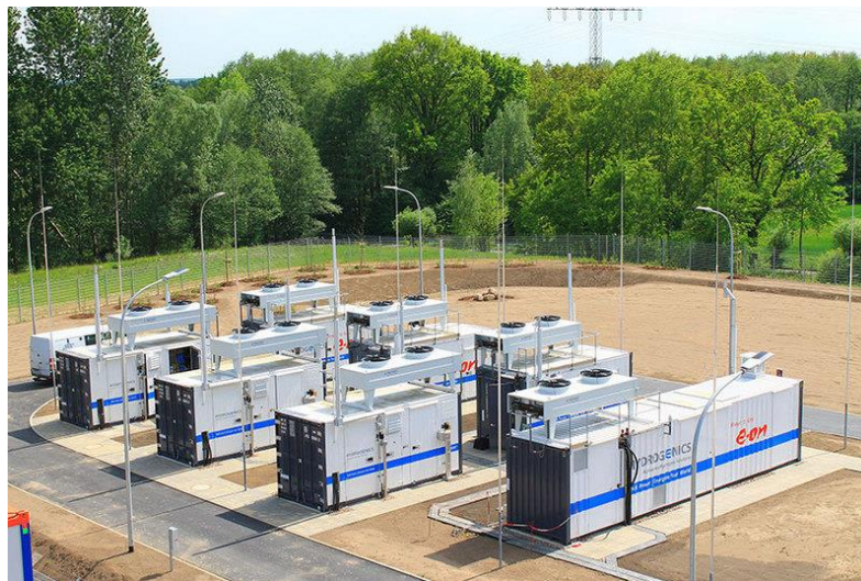
Abb. 7-10: Die PtG-Anlage in Falkenhagen
