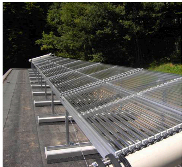
Abbildung 7: SOWARLA-Pilotanlage (Quelle: DLR)
