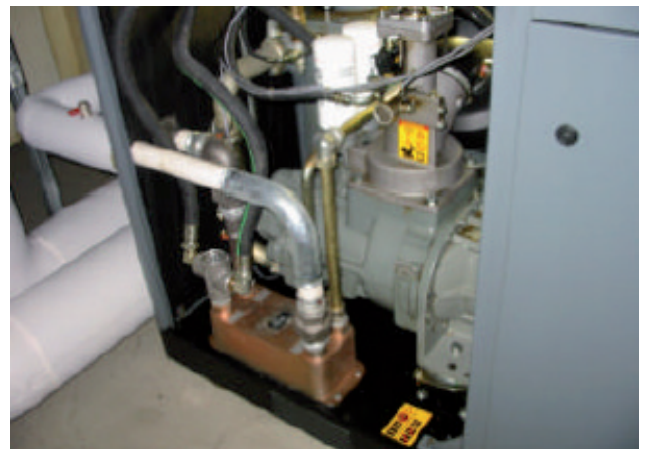
Wärmeauskopplung aus Kompressor
