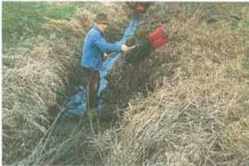
Abb. 44: Die Handräumung mit Spaten oder Schaufel eignet sich besonders zur Beseitigung kleinerer lokaler Anlandungen, z.B. vor Rohrdurchlässen.
