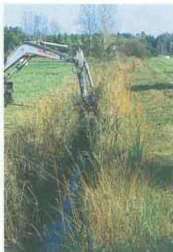
Abb. 48 und Abb. 49: Mit leichten Baggern auf Kettenfahrwerken kann auch auf empfindlichen Naßböden noch gut gearbeitet werden. Mit dem relativ kleinen Löffel ist es möglich, auch schmale Gräben unter Schonung der Ufervegetation zu räumen.
