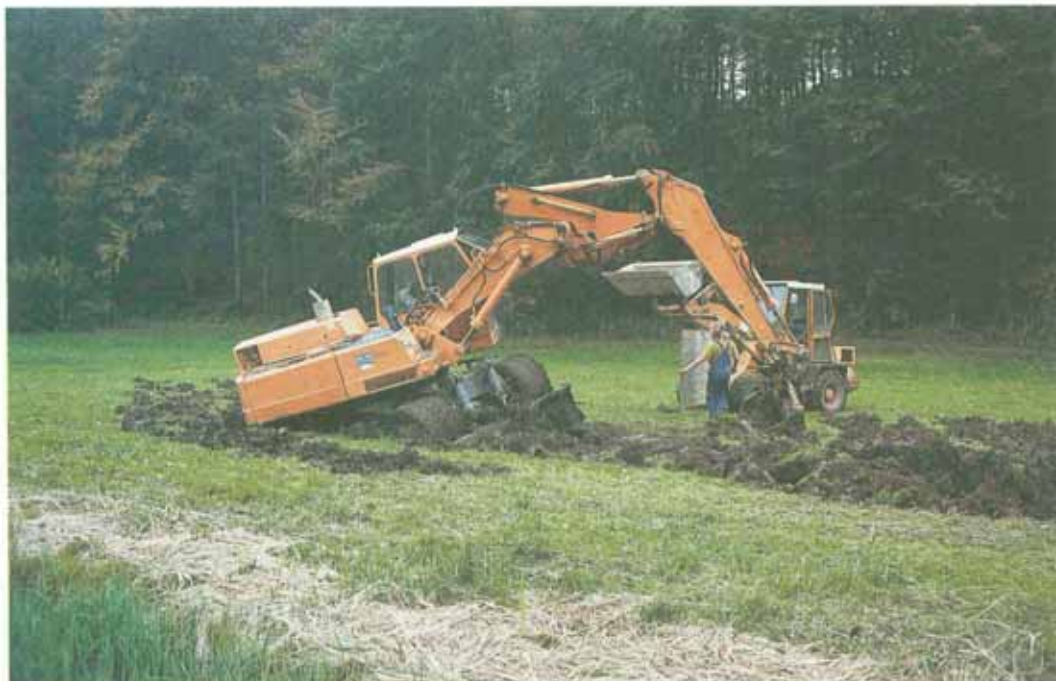
Abb. 63: Die Wahl geeigneter Arbeitsgeräte ist sehr wichtig. Bei der Räumung eines Grabens in einem entwässerten Niedermoor ist dieser Bagger auf Doppelbereifung eingesunken. Die Bergung gelang schließlich nur mit einer Raupenbagger, hohe Kosten waren die Folge. Auf empfindlichen Nassböden sollten nur leichte Geräte auf möglichst breiten Kettenfabrikerketten (Moorketten) eingesetzt werden.
