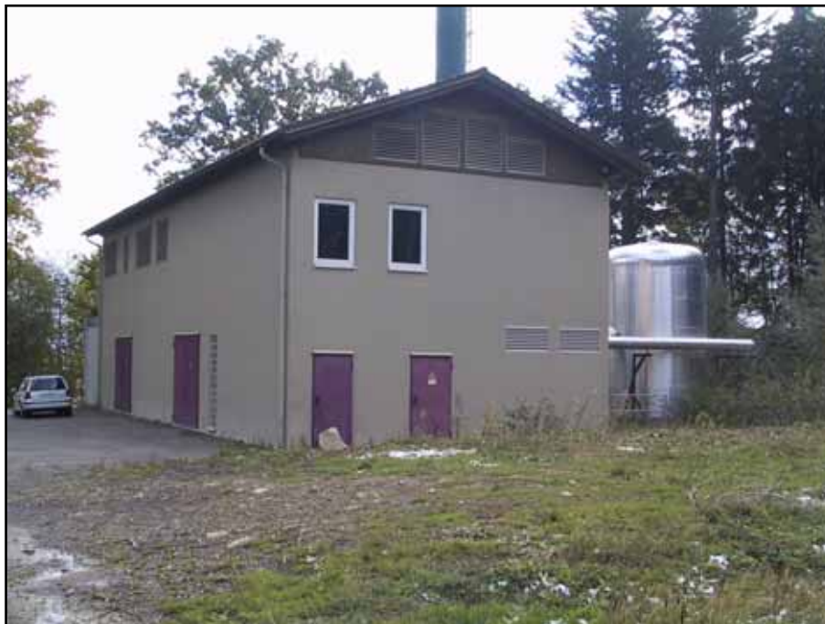
Abbildung C-2: Ansicht der Heizzentrale im Bollershofwald (Rechts im Bild ist einer der beiden Pufferspeicher zu sehen)
