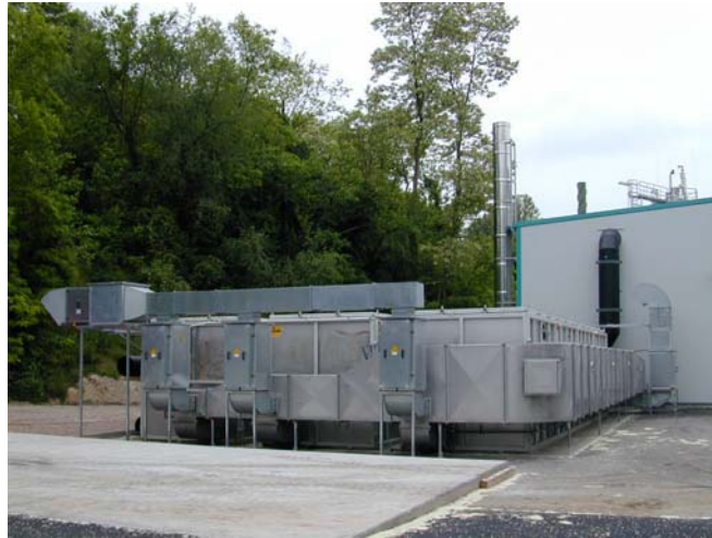
Abbildung 11-1: Ansicht Biofilteranlage und Ionisation (Zustand: 3 Biofilter), Frühjahr 2002
