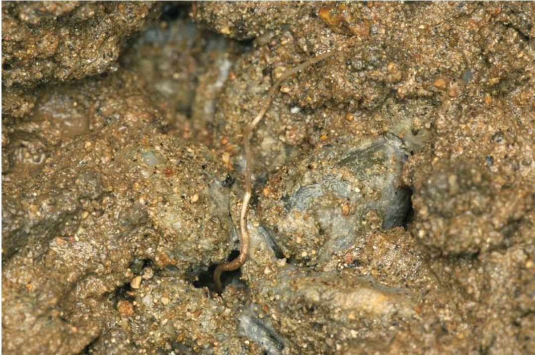
Bild 25: Eine Wurzel wächst in eine Haufwerkspore des Dränbetons ein.
