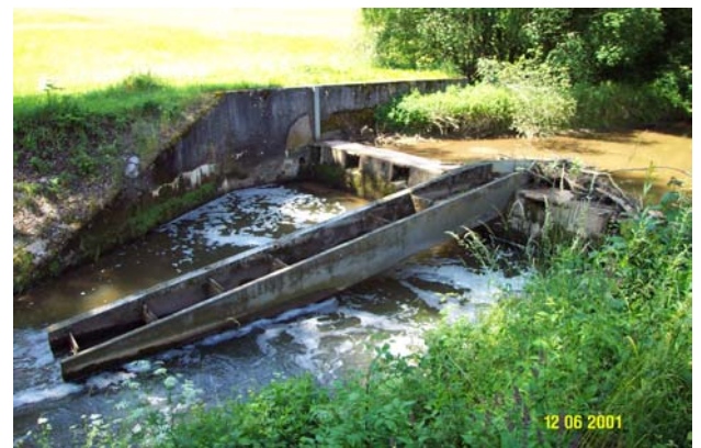
Abb. 50: Wehr vor der Umgestaltung (typische Verklauung am Fischpasseinlauf).
