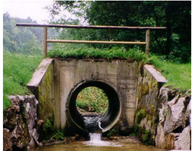
Abb. 19: Durchlass mit Absturz behindert die Durchgängigkeit.
