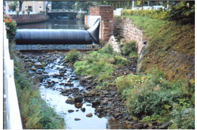
Abb. 31: Kein Abfluss unterhalb des Schlauchwehres und ein trocken gefallener Fischpass.
