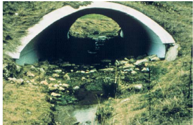
Abb. 63: Ausgeführtes Beispiel eines Durchlasses.
