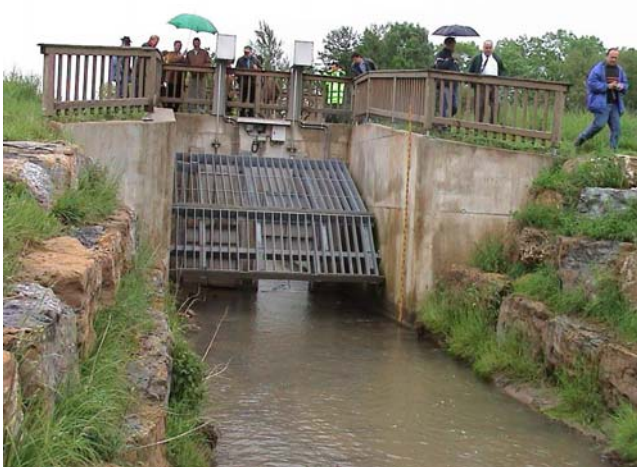
Abb. 62: HRB Raußmühle an der Elsenz.
