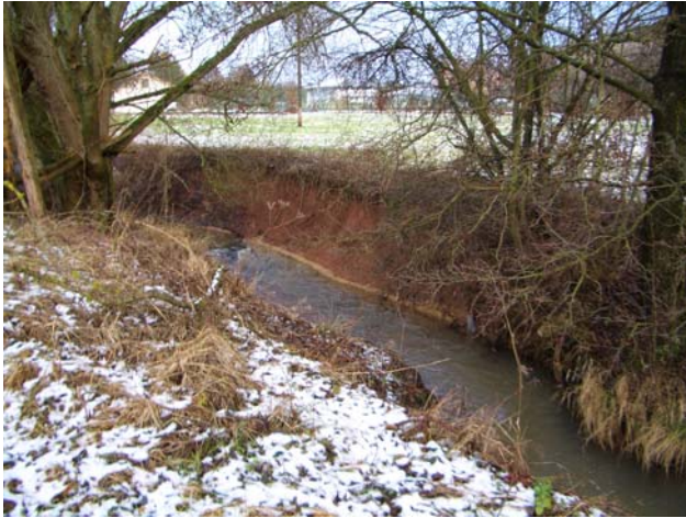
Abb. 29: Steile Ufer durch Tiefenerosion.
