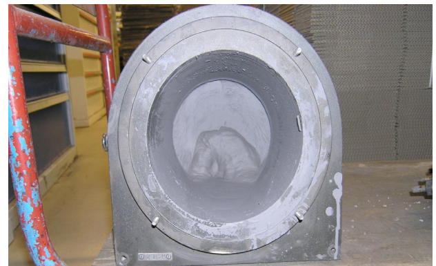
Farbablagerungen im Vorlagebehälter für Abdeckfarbe
