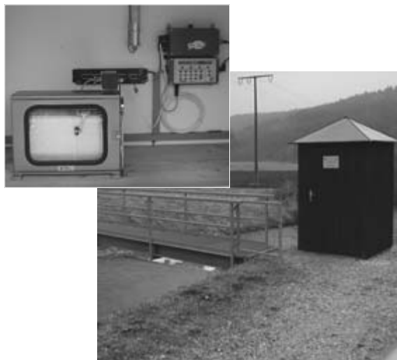
Eine vollautomatische Messstelle.
