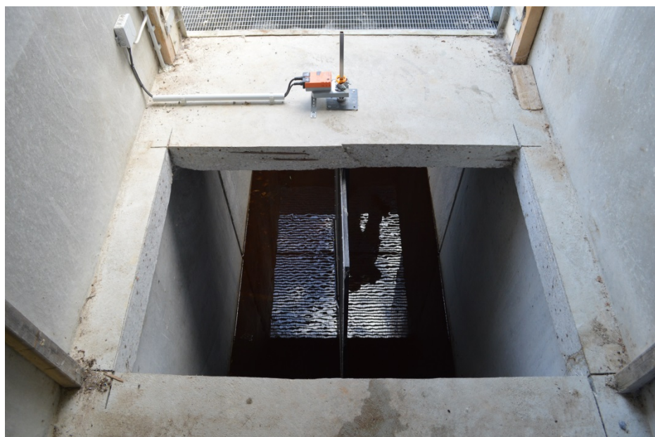
Abbildung 9: oben: Antriebs-/Stellmotor für Zuluftklappe mit Ansteuerung, unten: Zuluftklappe (ganz geöffnet)
