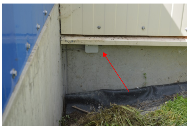
Abbildung 8: Temperaturfühler außen für Interaktion mit Regelung Zuluftöffnung
