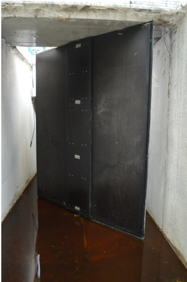
Abbildung 10: Zuluftklappe eingebaut in Unterflurzuluftkanal, 45° geöffnet
