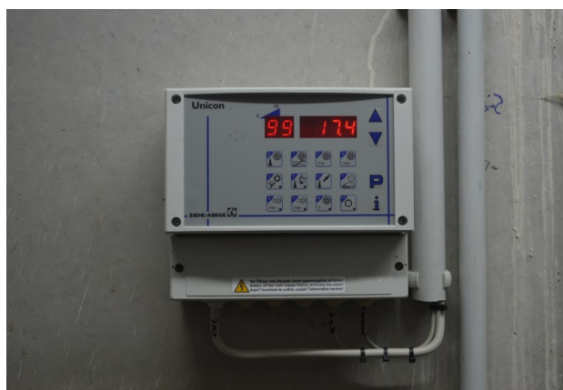
Abbildung 7: Stallklimacomputer für Regelung/Ansteuerung Zuluftklappe
