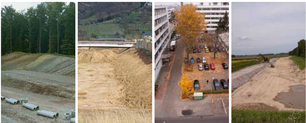
Abb. 3: Eingriffe in Böden – Abgrabungen (links und Mitte links), Versiegelung (Mitte rechts), Aufschüttung für technische Bauwerke (rechts)
