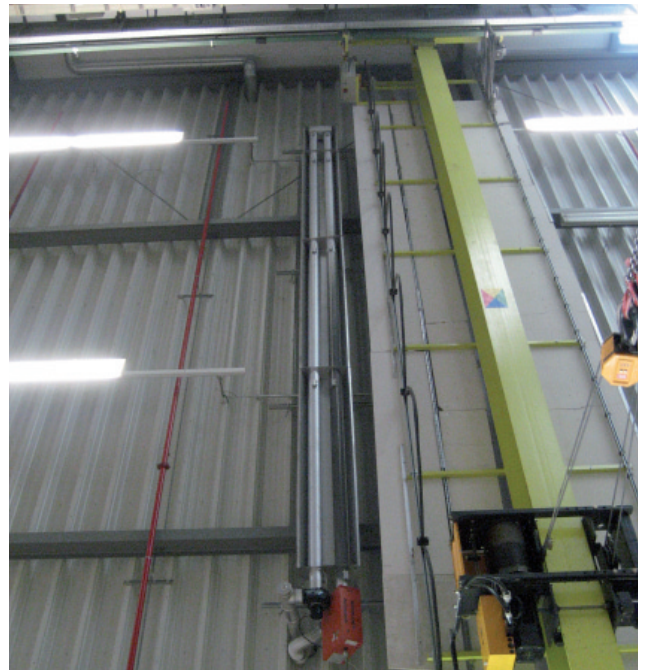
Dunkelstrahler an der Hallendecke
