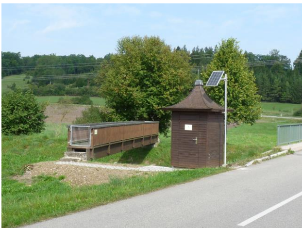
Bild 57: Unterspeltach-Speltach Pegelhaus mit Solarmesssteg 2011-08-31
