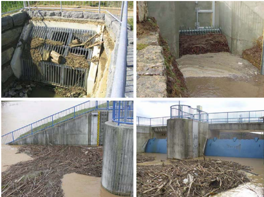
Abbildung 4.57: Gewschwemmseltrieb bei Hochwasser [ZVHWS]
