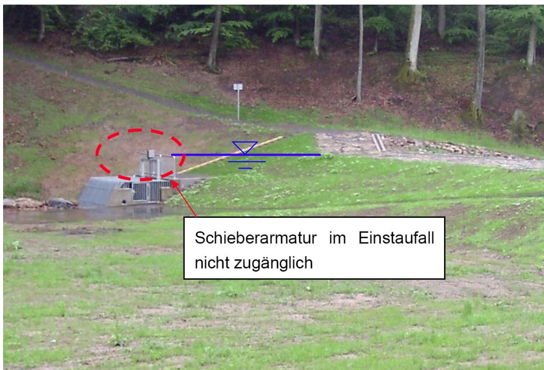
Abbildung 4.56: Bei Einstau unzugängliche Schieberarmatur.
