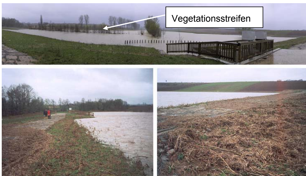
Abbildung 7.6: Geschwemmselanfall HRB Raußmühle beim Schadensfall im März 2002; [ZVHWS].
