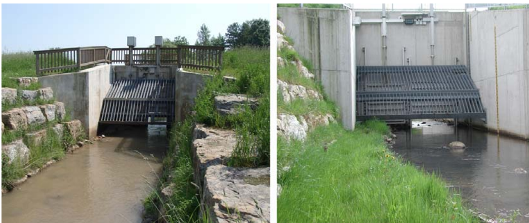
Abbildung 7.10: Räumlicher Feinrechen, HRB Raußmühle (links), HRB Möchzell (rechts).
