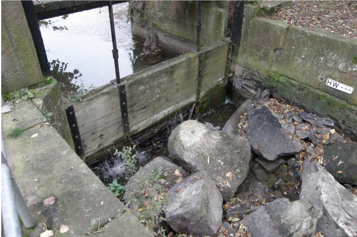
Abbildung A1-7: Ansicht des alten Schützes von Unterstrom (Stand 30.3.2009)
