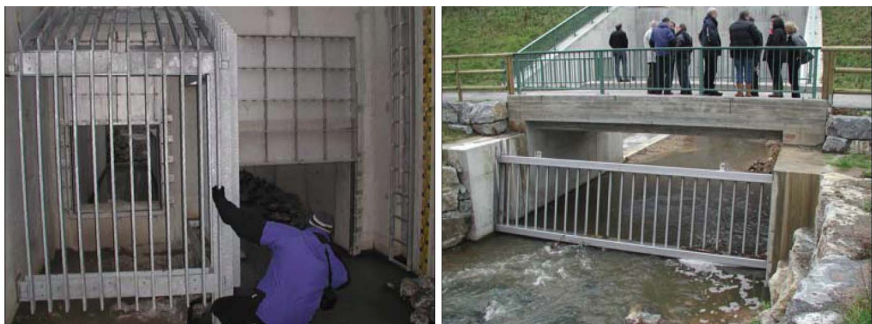
Abbildung 8.13: links: hochliegender Steuerschieber ohne Sohlanschluss behindert die Durchwanderbarkeit auf der Berme; rechts: Rechen oberstrom der Anlage ohne durchgängige Uferberme behindert die terrestrische Durchgängigkeit
