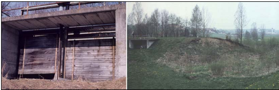
Abbildung 4.55: Verklemmtes Schütz, HRB Rot an der Rot, [Foto BERNHART]
