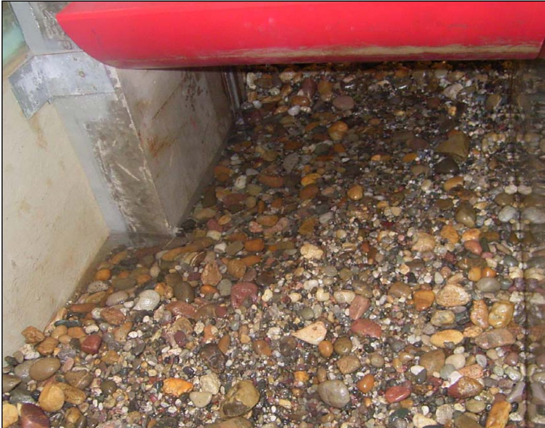
Abbildung 5.4: Durchlass nach einem Abfluss von 225 l/s und Fließgeschwindigkeiten von ca. 1 m/s
