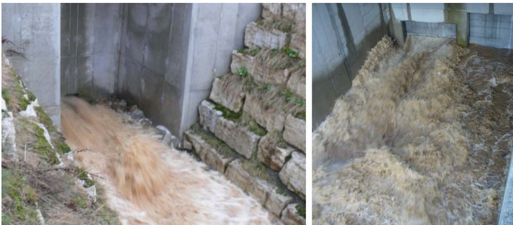
Abbildung 4.62: Abflussgeschehen unterstrom des Durchlassbauwerkes bei Hochwasser, HRB A26 Rittersbach (links), HRB M18 Mönchzell (rechts), [ZVHWS]
