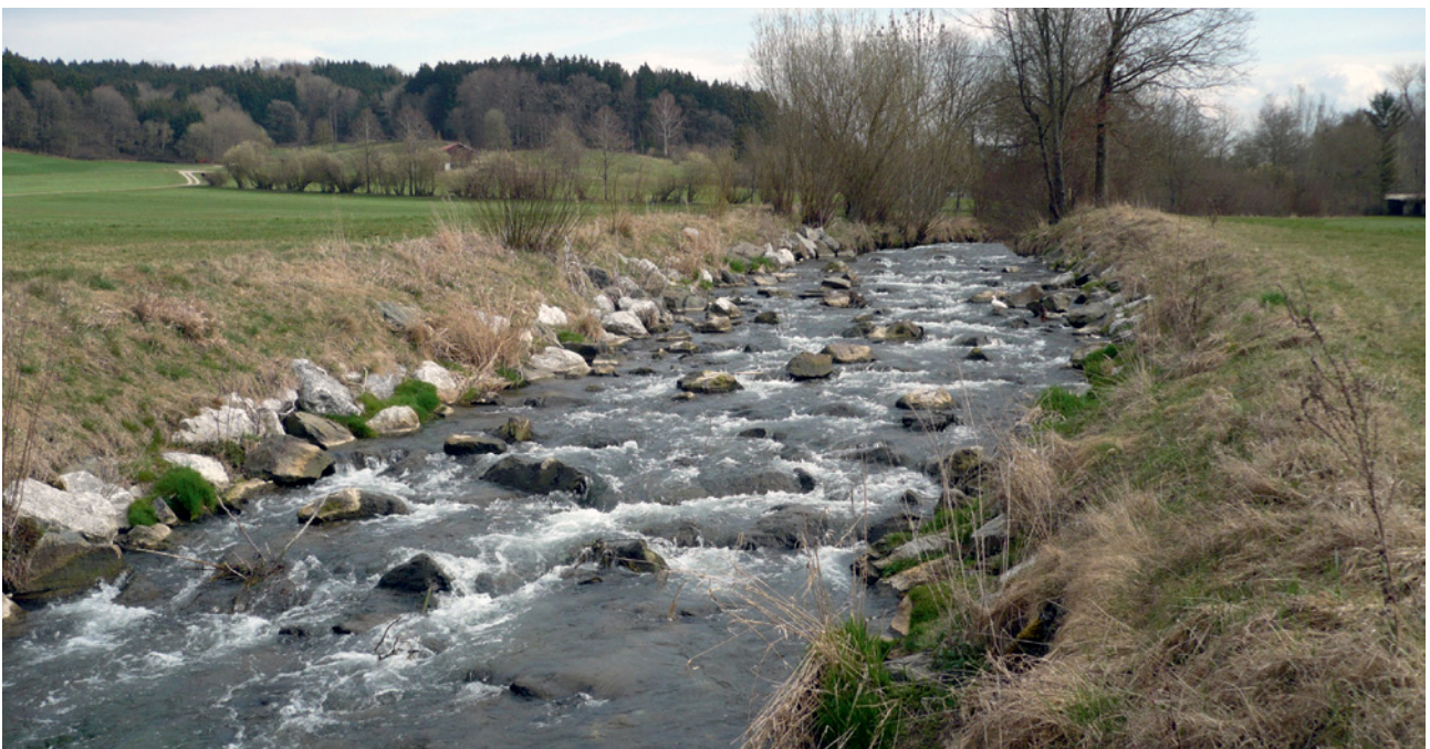
Abb. 5.10: Durchgängigkeit mittels Rauer Rampe wiederhergestellt
