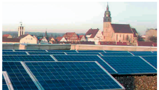
Photovoltaikanlage auf dem Dach des Landratsamtes
