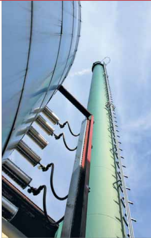
Kamin des Blockheizkraftwerks Bild: ENRW Rottweil
