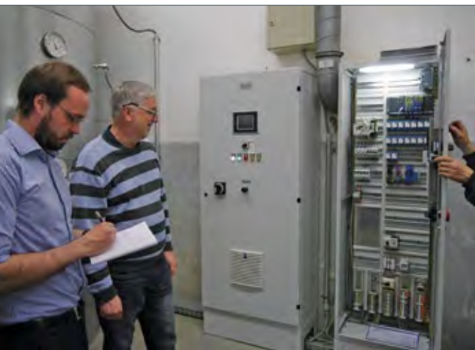
Datenaufnahme im Heizungsraum der Schule in Sigmaringen
