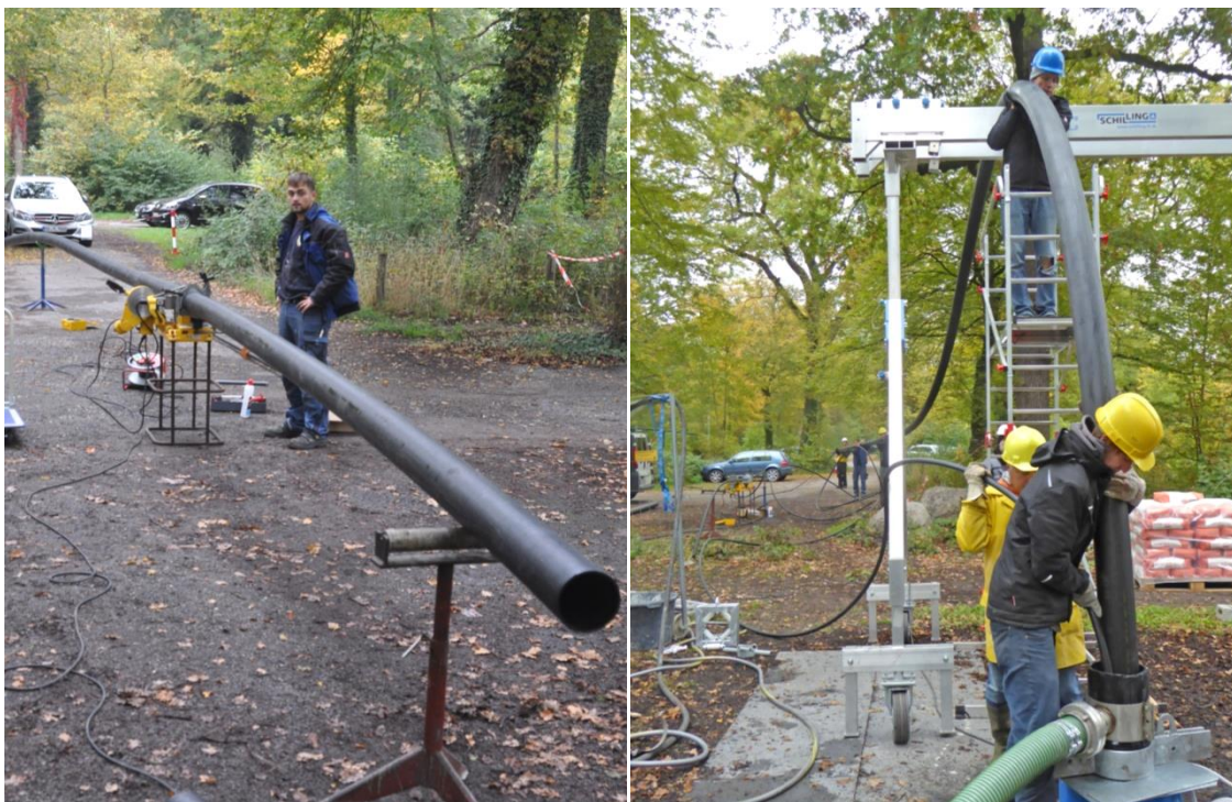
Abbildung 5-5: Einbau der Koaxial-EWS von EWS 4-W. Links: Verschweißen der einzelnen PE-Sondenstücke; rechts: Herablassen der zusammenschweißten Koaxial-EWS in das „Bohrloch“
