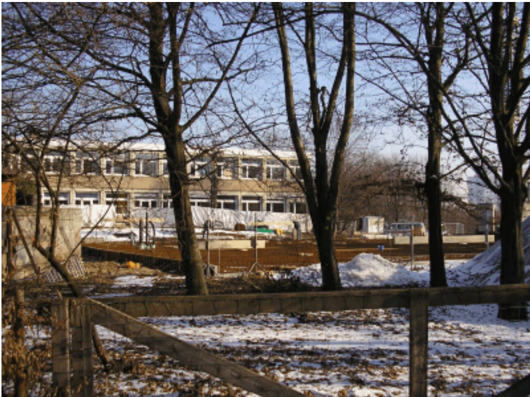
Abb. 23 Sonderschulzentrum Hengstäcker / Erweiterung der Bodelschwingschule: Blick von der Schule zur Baustelle und der dahinter liegenden Wohnbebauung (oben) und Blick von der Baustelle zur Schule (unten). Abschirmungen im Bereich zwischen Baustelle und Wohnbebauung sind problemlos möglich, aber auch zwischen Baustelle und Schule umsetzbar.
