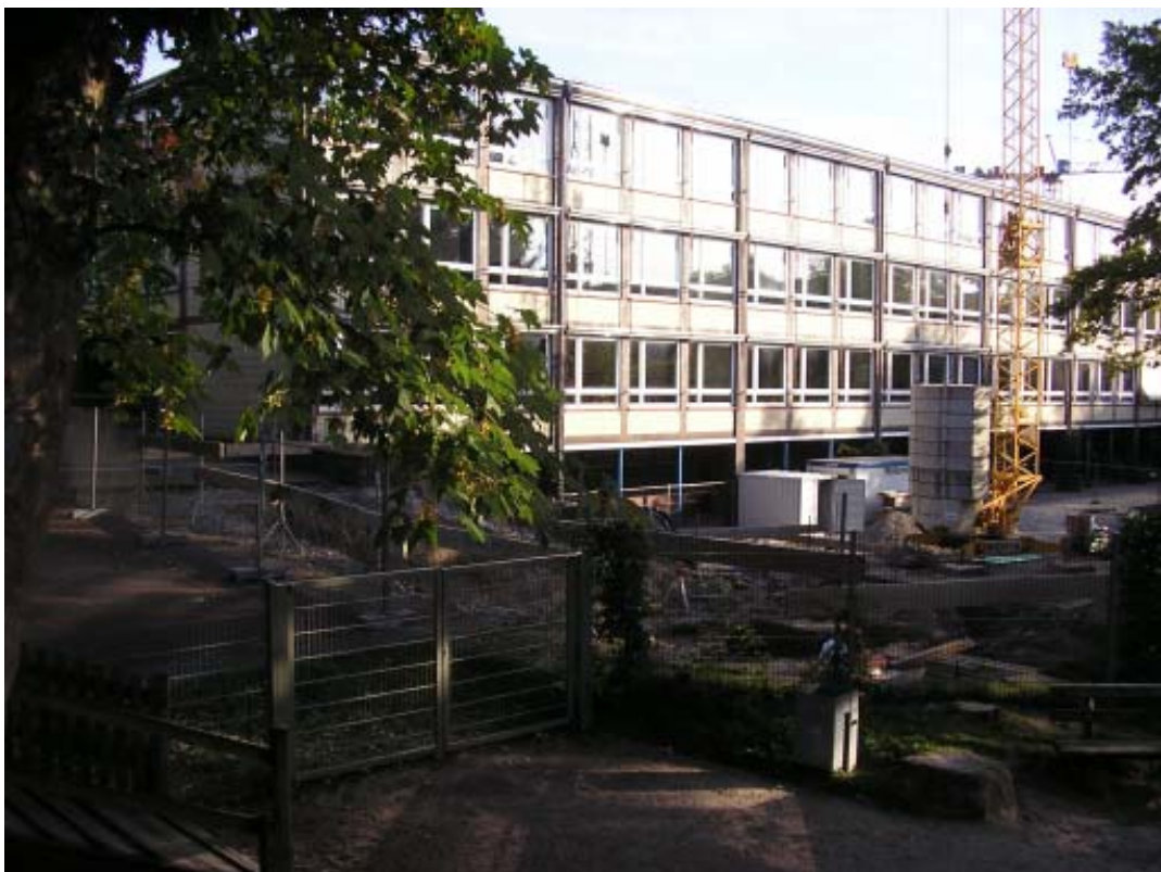
Abb. 25 Friedrich-Eugens-Gymnasium / Mensa-Anbau: Blick von der Schule zur Baustelle und der dahinter liegenden Wohnbebauung (oben) und Blick von der Baustelle zur Schule (unten). Abschirmungen im Bereich zwischen Baustelle und Wohnbebauung sind trotz beengter Platzverhältnisse möglich.
