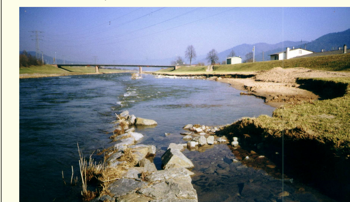
Erosion des Vorlandes an der Kinzig
