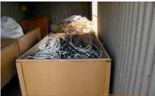
Foto 47: Abgetrennte Kabel, Beraubung oder gemeinsame Entsorgung mit Geräte-SG?
