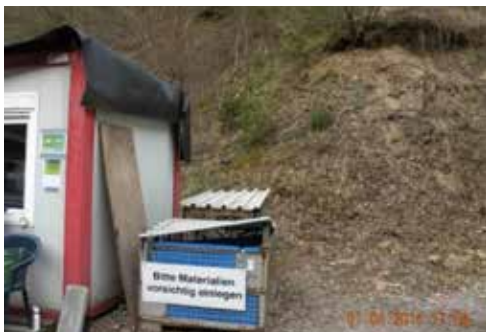
negativ: Ungeeignete Sammelstelle auf unbefestigtem Gelände
