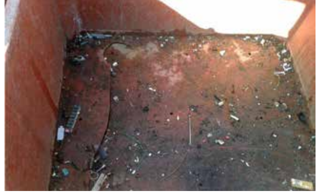
Foto 42: Negativ Beschädigte Sammelboxen
