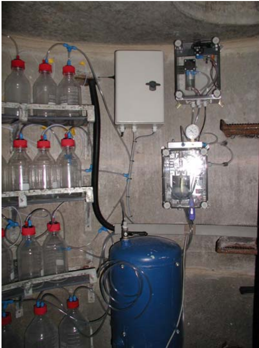
Pumpstation zur Sickerwassergewinnung
