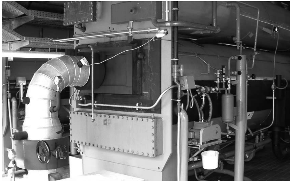
Abb. 6.2: Heizkessel in der Energiezentrale von Schwabe
