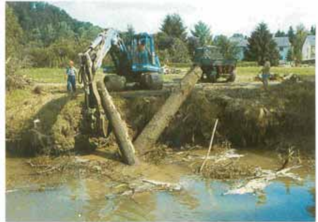
Abb. 65: Aufwendiges Entfernen der umgestürzten Pappel.
